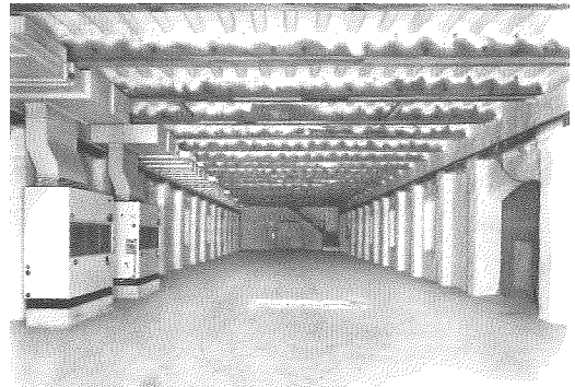
写1 修理前の状況
